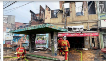
SALDO.— El siniestro dejó posibles personas atrapadas, inmuebles reducidos a escombros y la acentuación del deterioro urbano en el deshabitado barrio Puerto, de Valparaíso.
